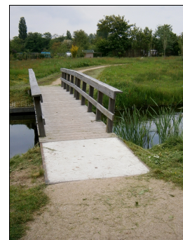
Verzakking opgevangen door stelconplaat
